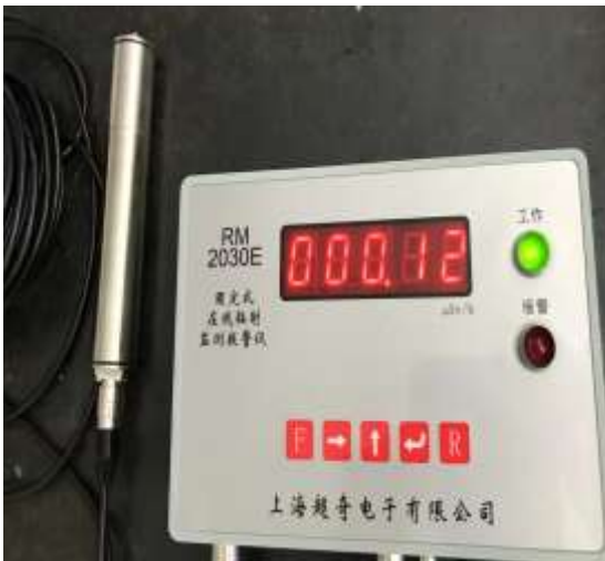
本项目迷道北墙剂量检测探头
